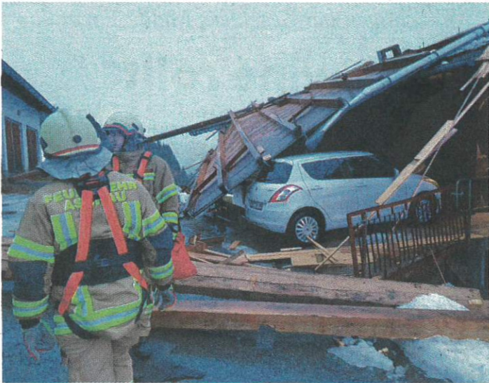
Dienstag Früh deckte der Sturm in Aschau das Dach eines Bauernhofes ab. Der Sachschaden ist groß. Fotos: Bezirksfeuerwehrverband (4)
